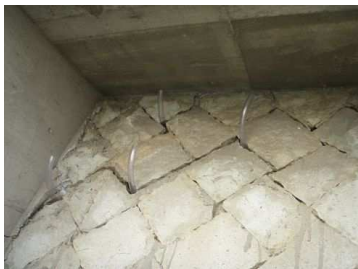
石垣背面の土砂が流出し空洞ができ、崩落の危険性があります。
