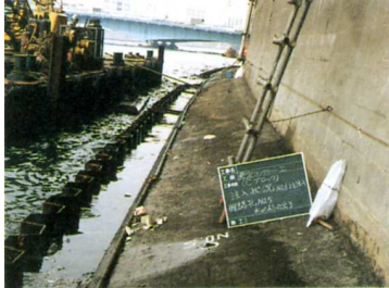
護岸下が地盤地下して、空隙部分に河川水が滞留しています。
